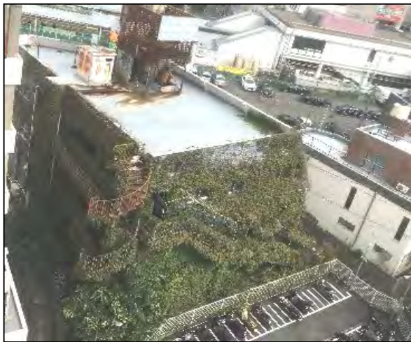
老朽化した建物
